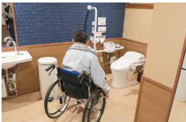
広々として使いやすい多目的トイレ
